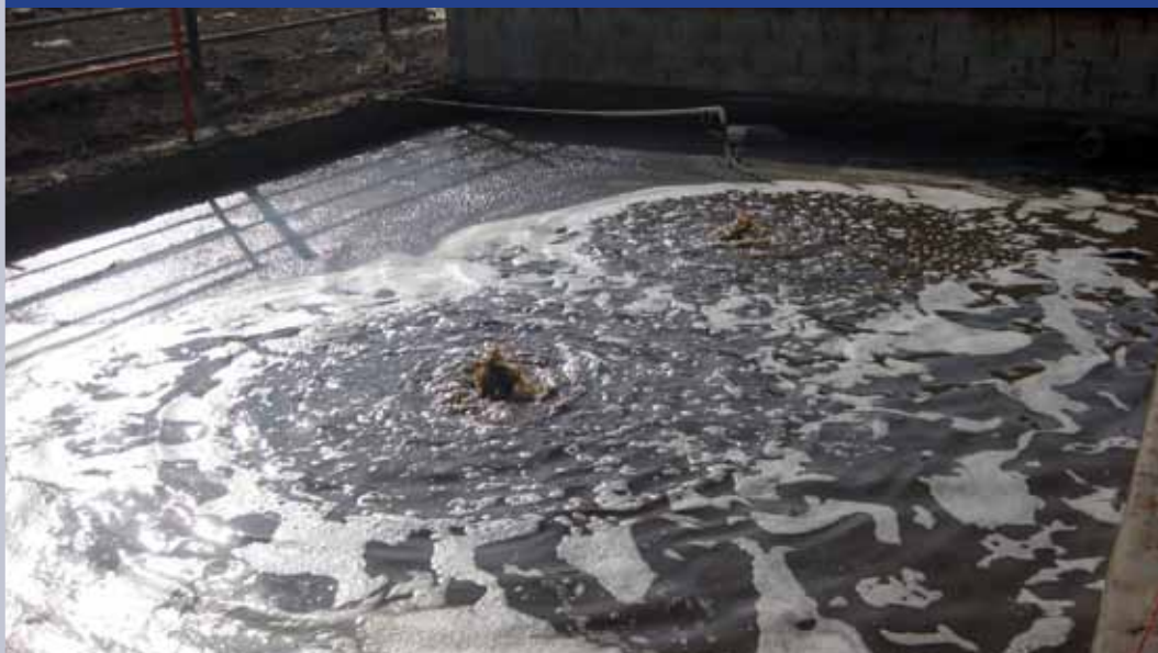
Ilustración 4. Laguna de aireación de la planta tratadora de aguas residuales
