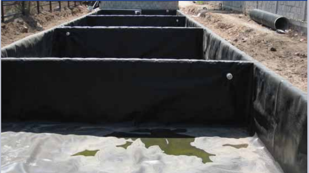
Ilustración 5. Lagunas de estabilización de la planta tratadora de aguas residuales
