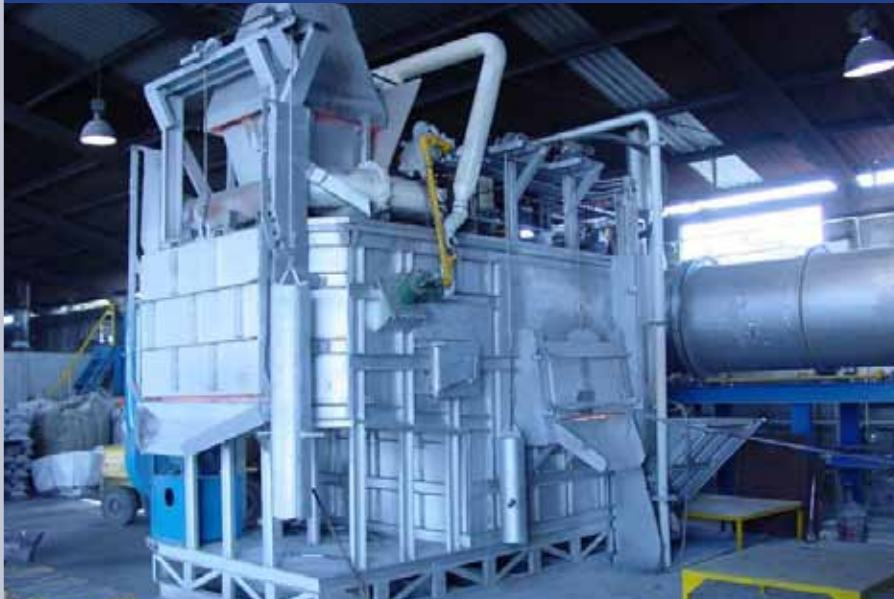
Figura 1. Fotografía mostrando el horno de reverbero de doble cámara diseñado y construido en este proyecto
