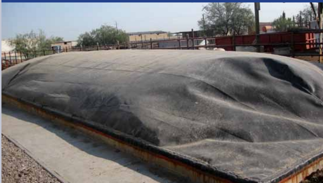
Ilustración 3. Biodigestor anaerobio de la planta tratadora de aguas residuales
