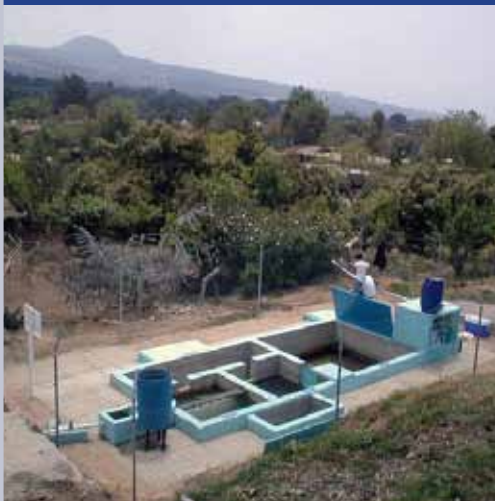
Figura 6. Planta potabilizadora de filtración en múltiples etapas modificada. Villa Nicolás Zapata, Morelos
