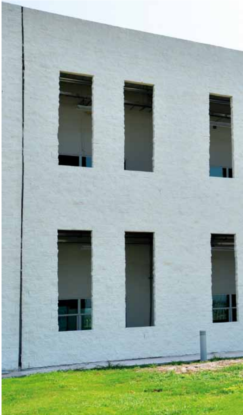
Centro de Investigación en Materiales Avanzados, S. C. (CIMAV), Unidad Monterrey dentro del Parque de Investigación e Innovación Tecnológica de Nuevo León.
