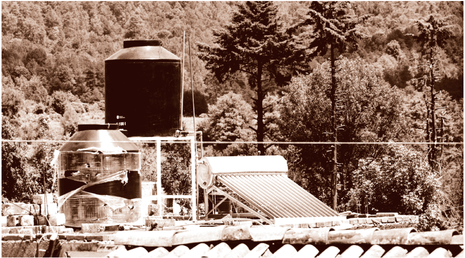
Calentador solar de agua utilizado en la comunidad de San Francisco Pichátaro, Michoacán. Foto: Jimena L. Paz Navarro.
