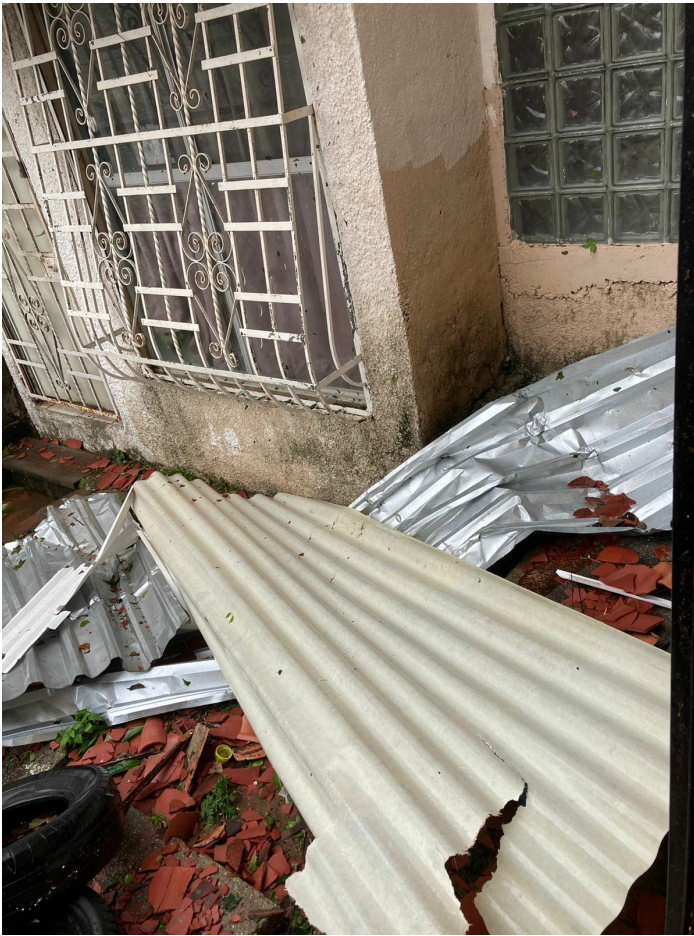
Figura 3. Accesos a casa habitación obstruidos por láminas y escombros. Fuente: Tomada por Esmeralda Vilchis.
