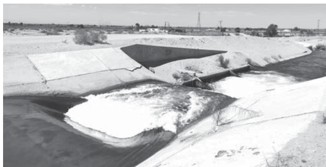
Figura 5. Sitio con potencial microhidroeléctrico en el Distrito de Riego (DR) 014 de San Luis Río Colorado
